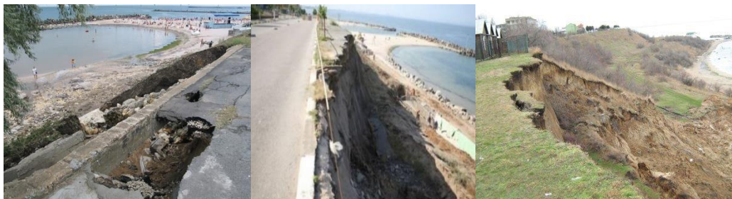
Fig. 1-2. Prăbușiri de faleză la Eforie Nord
